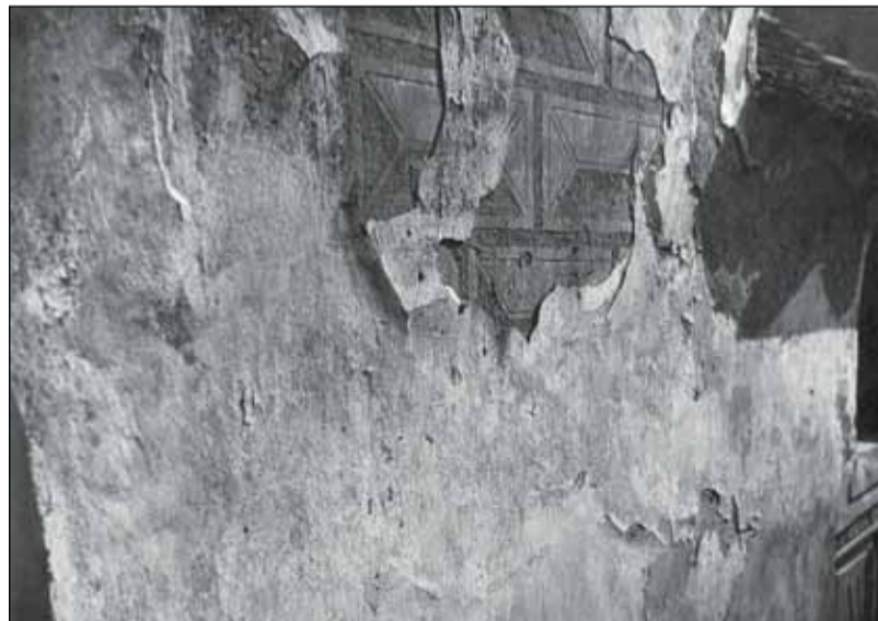
Sgrafita na presbytáři kostela sv. Bartoloměje vystupující pod opadanou omítkou.
